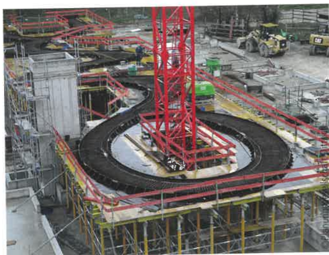
Abb. 6: Die Gründung inkl. Tiefgarage sowie die Erschließungskerne und die bewehrte Laubengangkonstruktion erfolgte mittels Ortbeton
